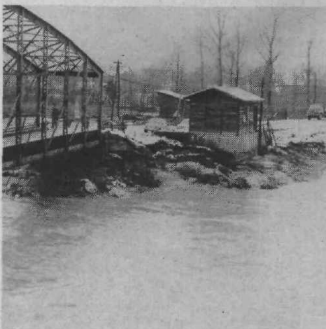
Opustošenje v Šentjakobu je bilo takšno, da že dolgo ne. Stari jekleni most se je sicer obdržal, toda po sliki sodeč ni dosti manjkalo pa bi bilo po njem.
