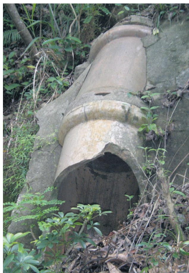
Foto: MZ V ptujskem vodooskrbnem sistemu je vgrajenih 12 odstotkov azbestno-cementnih cevi. V najslabšem stanju so PVC-cevi, ki so se vgrajevale v letih 1975–1985. So zelo krhke, na njih upravljavec beleži največ okvar.
