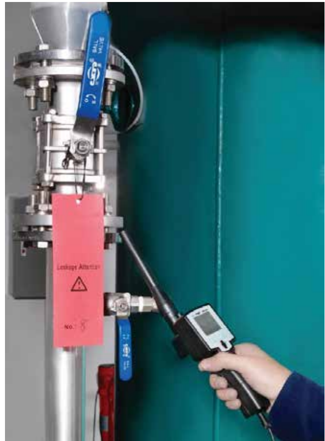
Slika 3 : Meritve puščanja stisnjenega zraka
