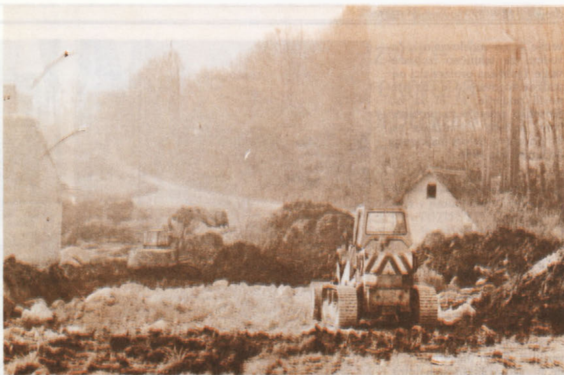
OBVOZNIČA — Tam, kjer smo še pred nekaj leti udarniško gradili ograjo, je sedaj zopet gradbišče. Tokrat gre za hitro obvoznico, kot pravijo nekateri. Domačini pa vedo povedati, da graditelji ne ravnajo najbolj umno, saj so zasipali strugo „obrha“, ki je sedaj sicer suha. Vsi so si edini, da bo to vprašanje zelo aktualno že ob malo večjem nalivu. (Fotografirano: 24. 11. 1981)
