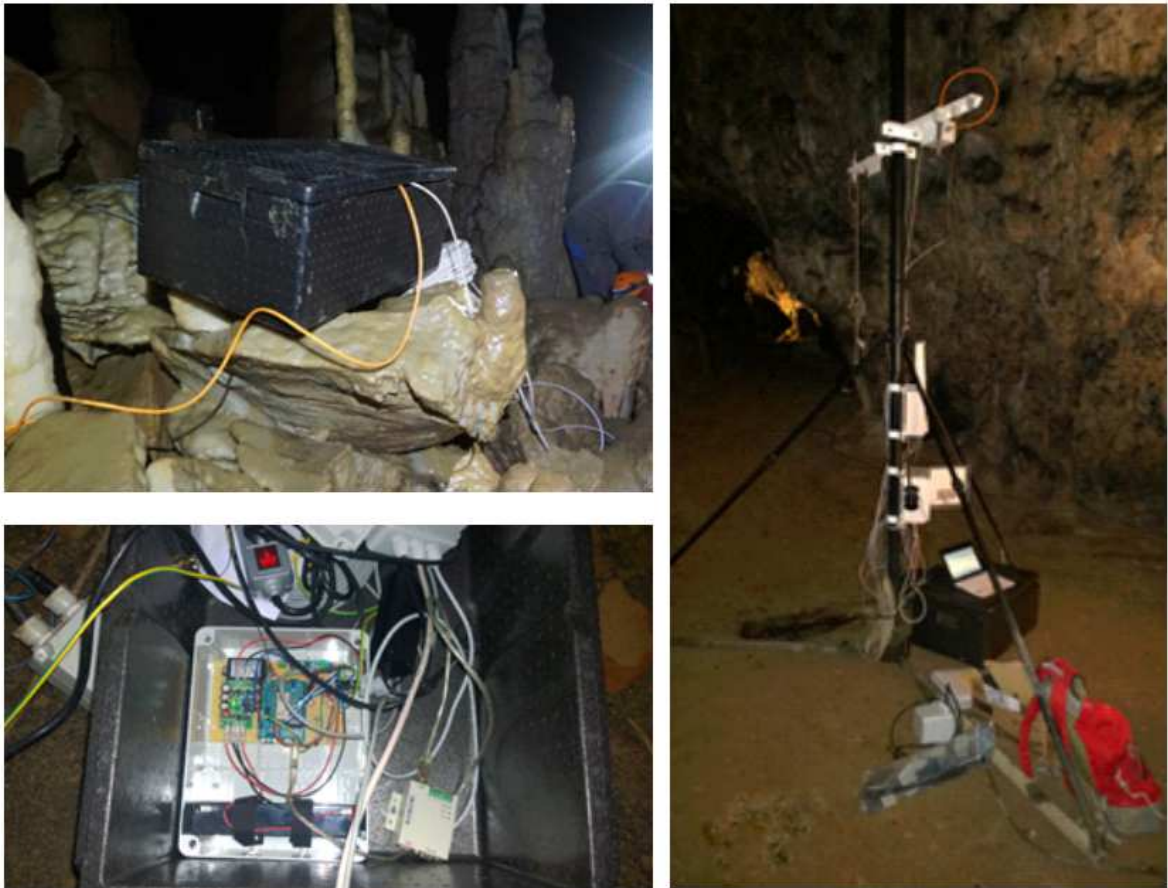
Slika 4: Slike jamskih avtomatskih merilnih postaj za meritve na lokacijah »Pisani rov« (levo zgoraj je slika izoliranega ohišja v katerem se nahaja merilni vmesnik, levo spodaj pa slika okoljskega vozlišča »JaMo« prav tako v izoliranem ohišju) in »Vodopad« (desno)
