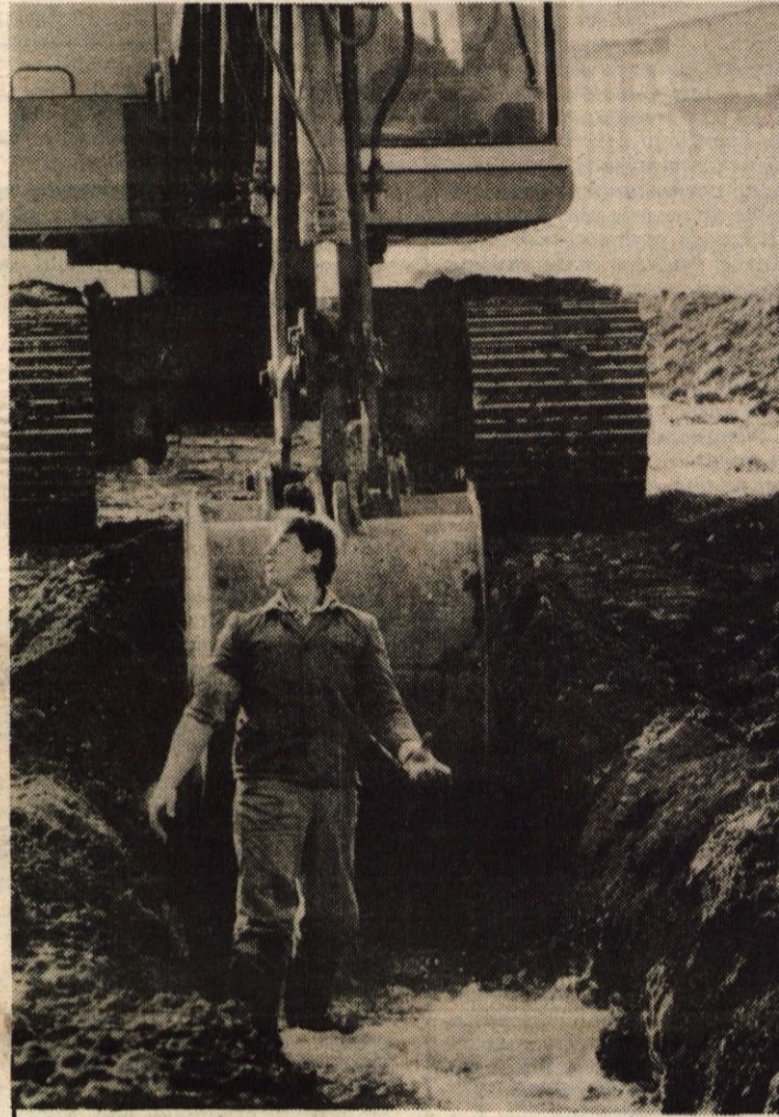
Ob kopenju zemlje za plinovod v Kranju se je spet zgodilo; bager je pretrgal vodovodno cev, voda je zalila izkop, povzročila nove nepotrebne stroške in delo. Ob tem vprašujemo; je kriva nepazljivost oziroma malomarnost bagrista ali pa je dokumentacija o ceveh, ki so že v zemlji, tako nejasna in pomanjkljiva, da se poškodb ni bilo mogoče ogniti. - Foto: F. Perdan
