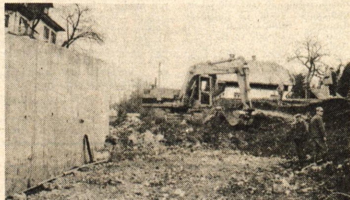
V torek so se na skupinskem ogledu gradnje ceste v Spodnjem Lomu odločili, da ograje pred šolo ne bodo podrli, hkrati pa cesto uredili tako, da bo varna za šolarje...
