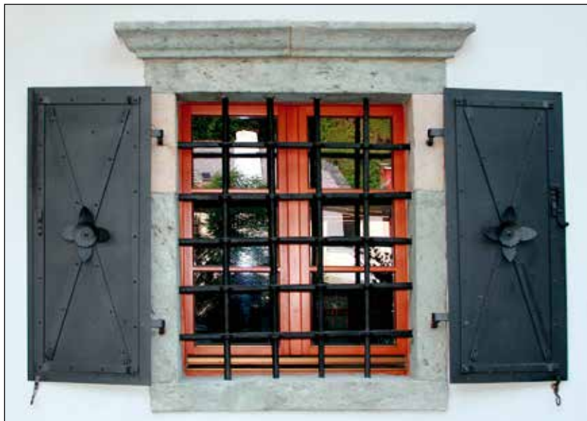
Okno s kamnitim okvirjem iz perachiškega tufa, z vgrajenimi kovanimi mrežami ter s kovinskimi polkni.
