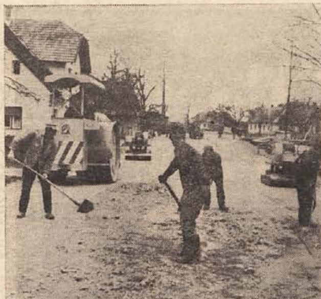
Most pri Goriči vasi je »Zidar« iz Kočevja zgradil že decembra lani. Zdaj Cestno podjetje Novo mesto dokončuje cestna priključka z obeh strani mostu. Predvidevajo, da bodo dela končana in most predan prometu do 1. maja. (Foto: Primc)
