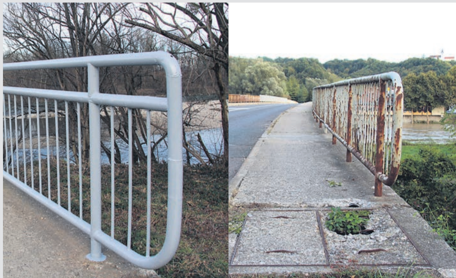
DRSI je opravila ogled delovišča in ugotovila, da se obnova ograje ne izvaja v skladu z dogovorom.
