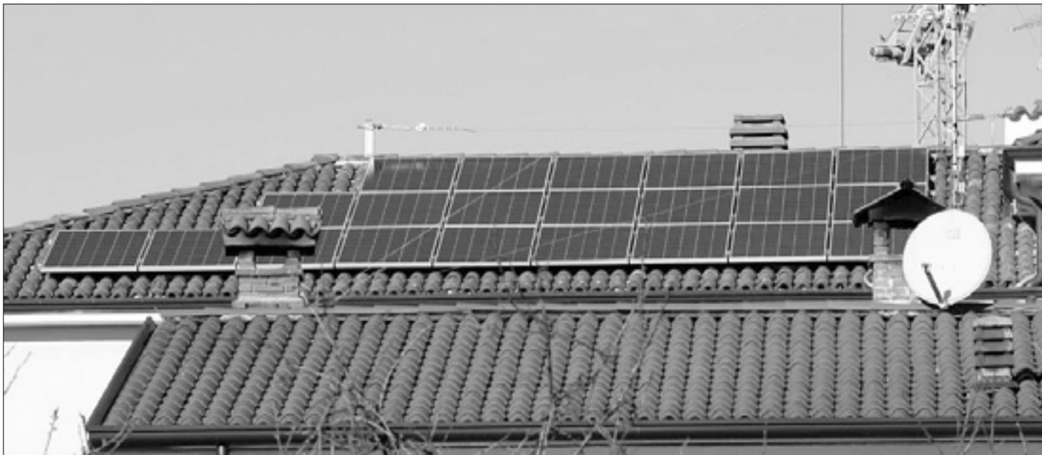
Fotovoltaični panoi na strehi osnovne šole v Doberdobu
