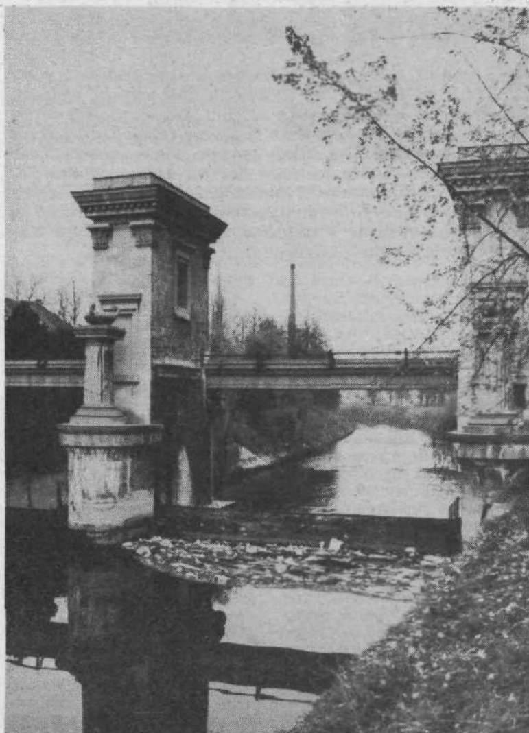
Pokojnemu arhitektu vsa čast. Bil je velik esteta tudi pri gradnji zapornice na Ljubljani. Seveda pa to, kar je običajno za zapornicami, ni njegovo delo, ampak plod naše »kulturnosti«.
