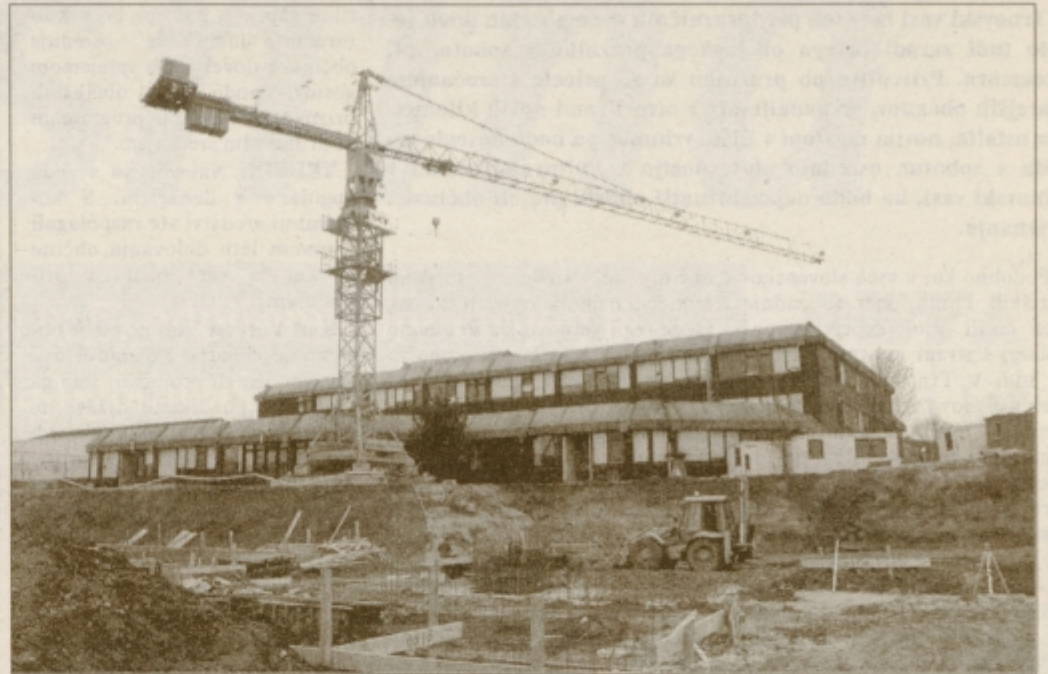
Ko je skopnel sneg, se je šele videlo, kako živahno je na gradbišču gimnazijskega poslopja. Foto: Črtomir Goznik
