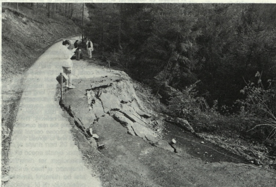
Sl. 2. Splazitev dela cestnega telesa vsled slabega dreniranja zaledne vode
