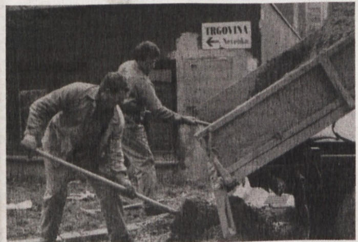
DELAVCI NOVOGRADA ZADELALI LUKNJO - V blokovskem naselju Plava laguna je bila ob cesti v neposredni bližini kurilnice že nekaj časa globoka luknja, ki je ogrožala varnost ljudi, predvsem otrok. Pred kratkim jo je nekdo pokril z železom, prejšnji petek pa so jo z betonom zadelali delavci novomeškega Novograda. Globoko luknjo naj bi naredile meteorne vode, zanimivo pa je, da se je pojavila pred kratkim, po tistem, ko so lani napeljevali plinovod. (Foto: J. Dornič)
