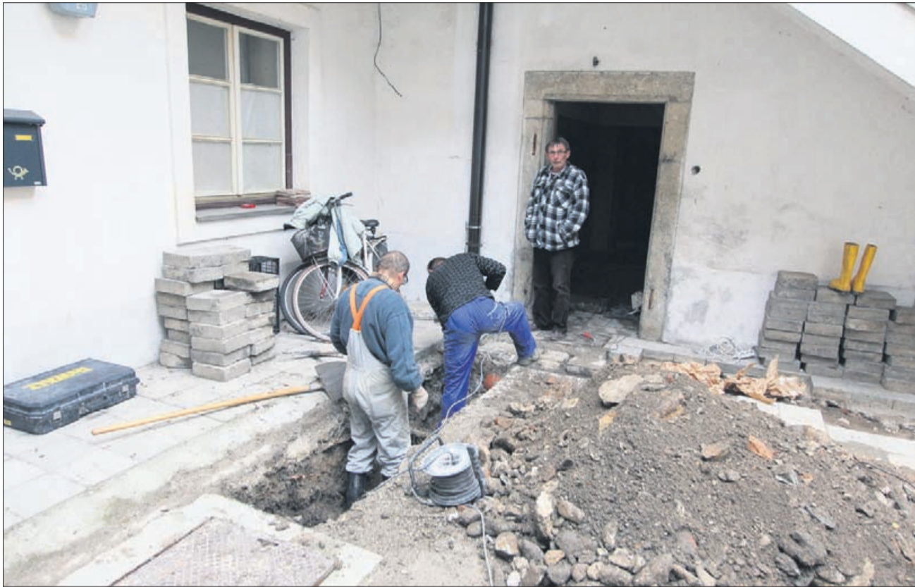
Delavci so začeli kopati pred enim tednom in tudi že zaključili sanacijo kanalizacije. Morda pa bodo stanovalci po šestih letih vendarle lahko kmalu odprli okna. Ne da bi jih ubijal grozljiv smrad.
