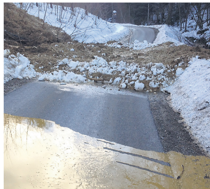
Ceste je zasula zemljina, zalila jih je voda.
