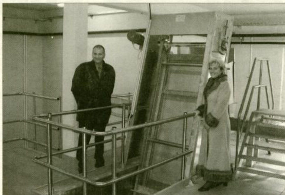
Vodja celjske centralne čistilne naprave Roman Kramer in vodja obratovanja čistilnih naprav Urša Drugovič ob grabljah, s katerimi odstranjujejo iz odplak trdne delce.
