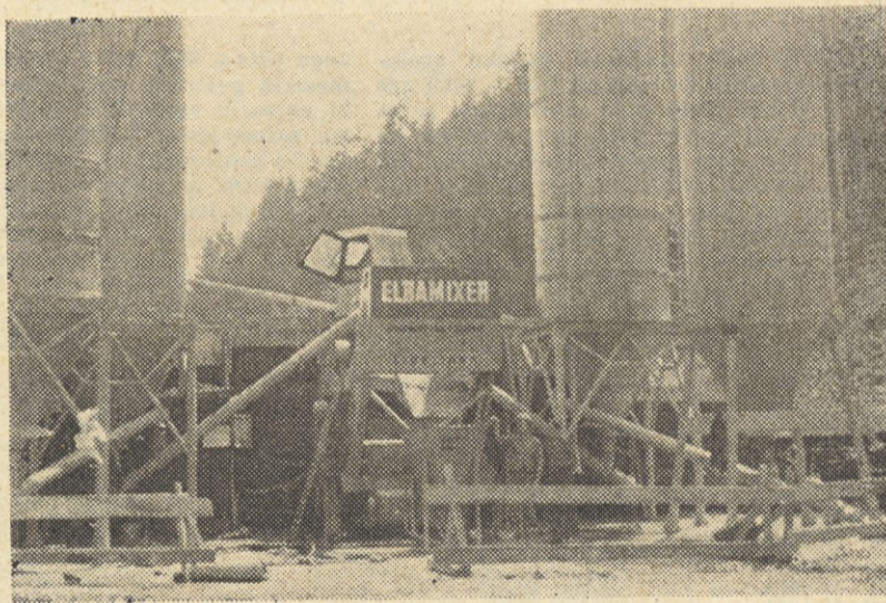
Betonarna na gradbišču TE Šoštanj III
