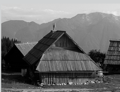
□ Slika 10. Zaščita lesene zgradbe na izpostavljeni severni strani z vertikalno postavljenimi skodlami in deskami
