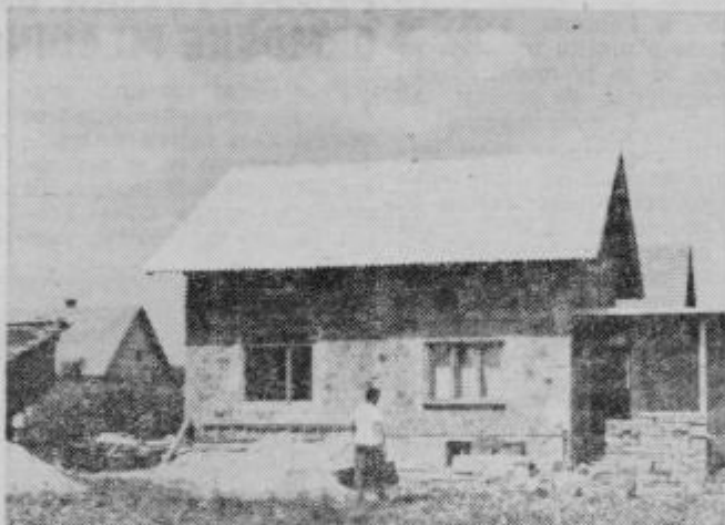
Hiša v naselju na Turnišču, h kateri je že peto leto omogočen dohod le od »zgoraj«. Vindiševi in ostali kupci gradbenih parcel zaman čakajo na dovoz
