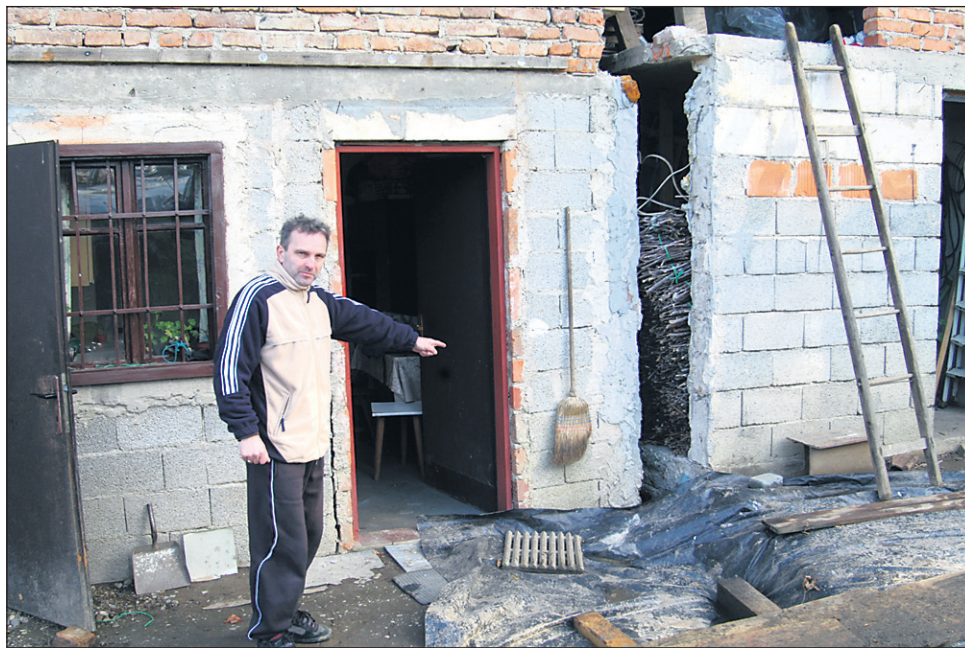
Gospodarsko poslopje na dvorišču Erjavčeve hiše je drseč plaz dobesedno prekal na dvoje.
