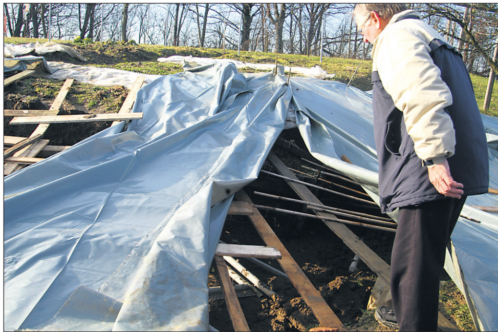
Razpoko v zemlji le nekaj metrov nad Erjavčovo hišo so gasilci zaradi dežja pokrili s plastično folijo; včeraj je bila široka že več kot 4 metre.
