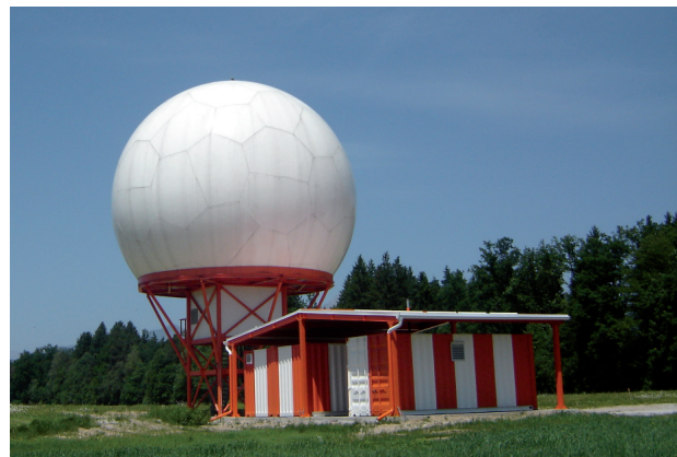
Slika 1a. radar STAR 2000 na letališču Jožeta Pučnika Ljubljana. Antenski del je nameščen v kupoli, ki je okoli 5 m dvignjena od tal. Antenski podstavek je nameščen v zabojniku pod ploščadjo kupole. Poleg vidimo radarska zabojnika s pripadajočo opremo. Lokacija ni primerna zaradi bližnjih ovir (dreves, stavb) in zaradi talnih ovir, ki obdajajo Ljubljansko kotlino (Foto: KZPS)
