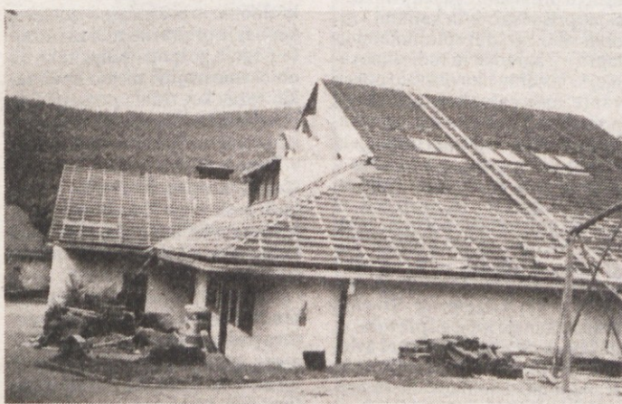
PREKRIVAJO ŠOLO IN POŠTO - V Strugah bodo lepe poletni dni izkoristili za prekrivanje strehe na šoli in na pošti. Ta dela so načrtovali že več let, na vrsto pa so prišla šele zdaj. Dela izvaja zasebnik iz Dolenje vasi. (Foto: J. Primc)
