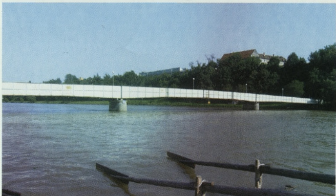
Slika 3 • Danes je brv prenizka in dotrajana do te mere, da obnova ni smiselna
