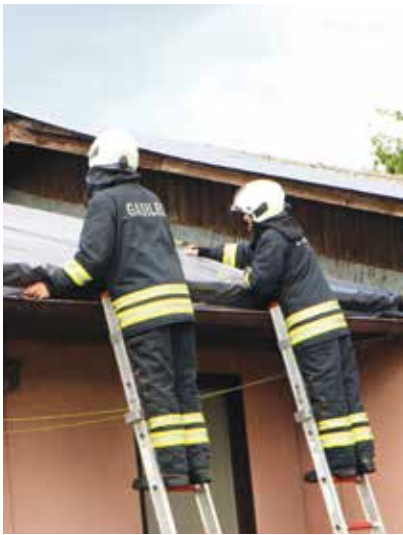
Na pomoč pri zavarovanju streh, največ v Vrbbju pri Žalcu, da škoda ni bila še večja, so tudi tokrat priskočili gasilci.
