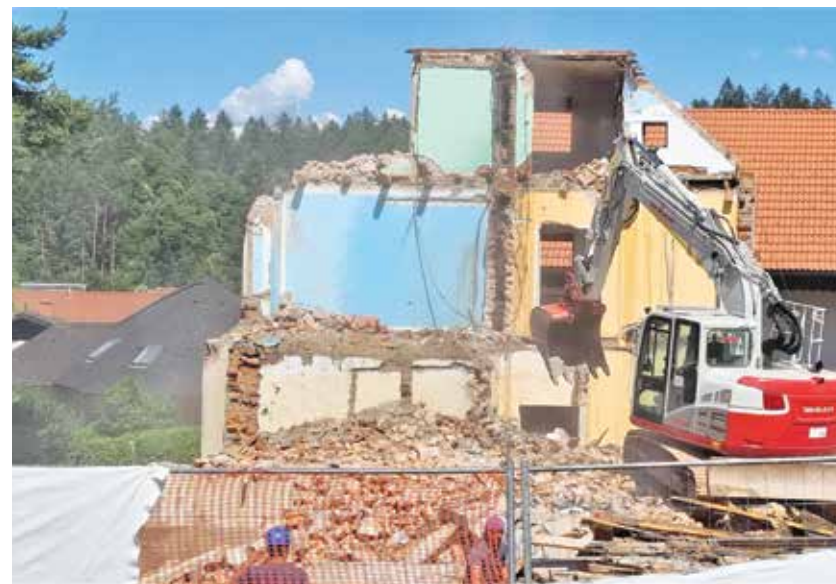
Rušenje stavbe, ki je bila zgrajena 1878. leta in je predstavljala že nevarnost za stanovalce.
