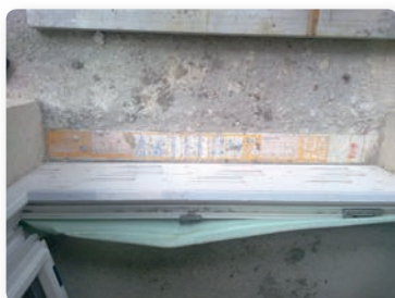
Toplotni most rešen s tipskim elementom, pogled od zgoraj po izdelavi balkonske plošče
