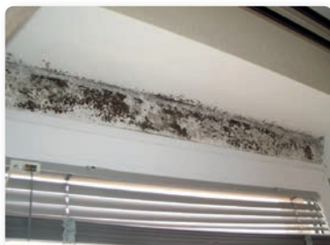
Plesen na konstrukcijskem toplotnem mostu - neizolirana preklada
