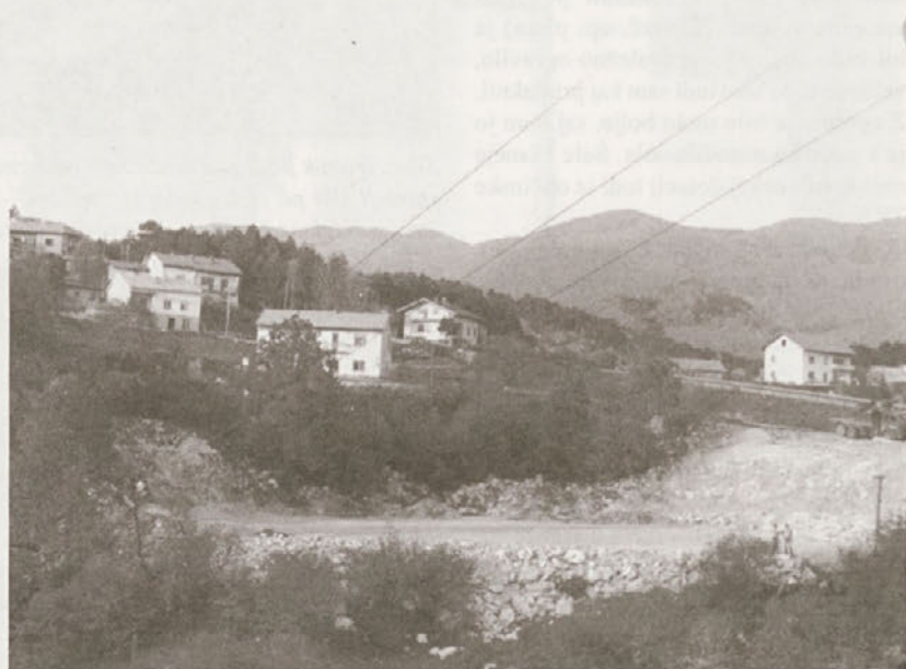
Pogled na bodoče igrišče s ceste, ki pelje proti Predmeji. Od daleč je gradbišče res izgledalo kot kamnolom. Da je kamnolom tudi v resnici bilo, pa vedo povedati tisti, ki so se v njem potili s krampi, macolami, ... (Foto. Arhiv Rokometni klub Col)
