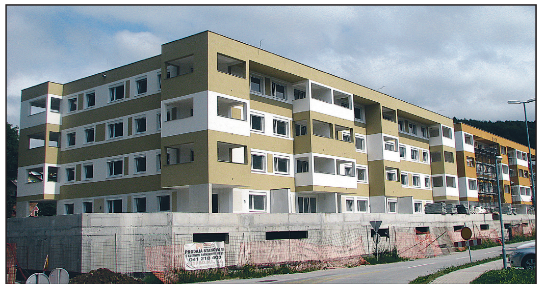
Stanovanjska soseska na Selu dobro napreduje, kljub temu da se je znašlo podjetje sredi gradnje v velikih likvidnostnih težavah. Banke so nenadoma zmanjšale višino kreditiranja.
