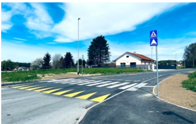
Obnova dela Volkmerjeve ceste do Mestnega Vrha v dolžini 880 m. Razširili in preplastili smo vozišče, zarisali smo pomožne kolesarske pasove po celotni dolžini, izgradili pločnik v dolžini 350 m ob levi strani vozišča ter uredili javno razsvetlavo na manjkajočem delu.
