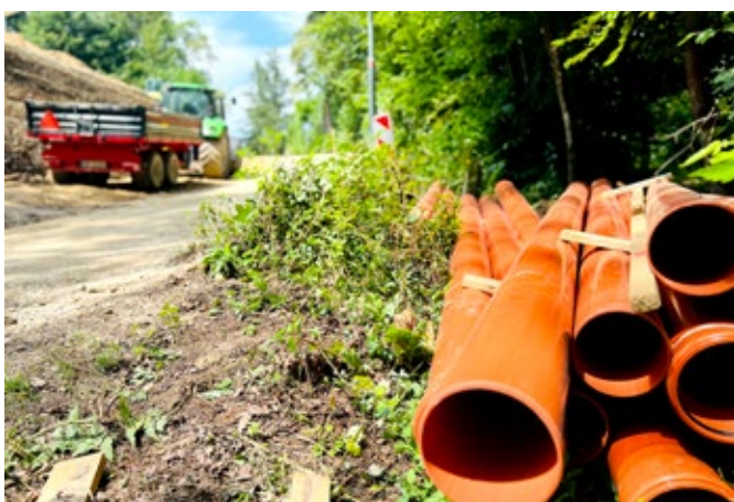
Zaključena je gradnja preko 33 km kanalizacijskega omrežja v sklopu projekta »Odvajanje in čiščenje komunalnih odpadnih voda v porečju Drave na območju Mestne občine Ptuj«, ki je bila razdeljena na sedem območij. Na javno kanalizacijsko omrežje smo priključili skupaj 699 priključkov s približno 2000 prebivalcev ter 16 črpališč.
