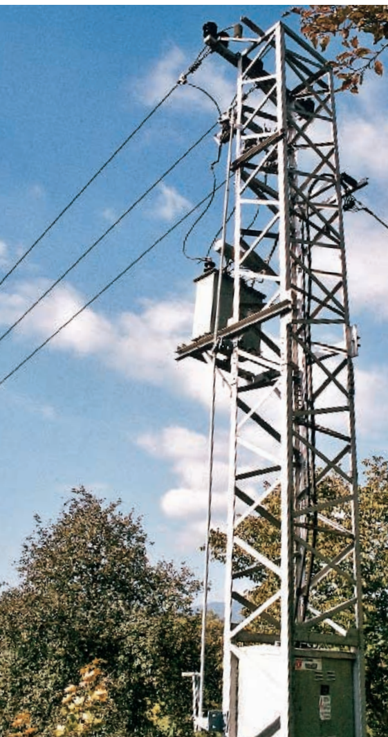
20 kV daljnovod za napajanje jamborske transformatorske postaje Ribenska 20/0,4 kV.
