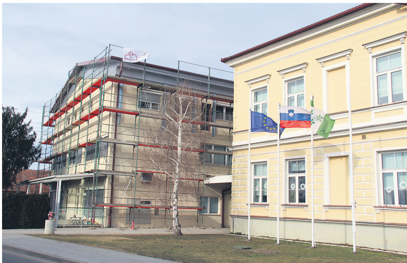
Na OŠ Cirkovce so že popravili streho, ki jo je decembra poškodoval orkanski veter.
