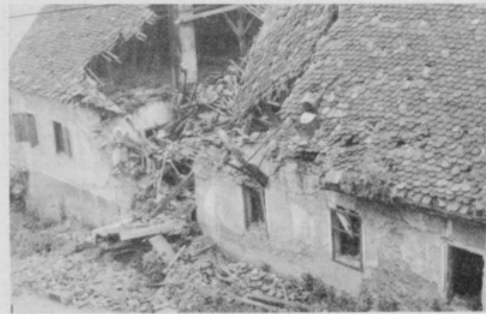
Stavba na Ptujski Gori 41, ki jo je krajevna skupnost prodala, je bila že precej dotrajana.
