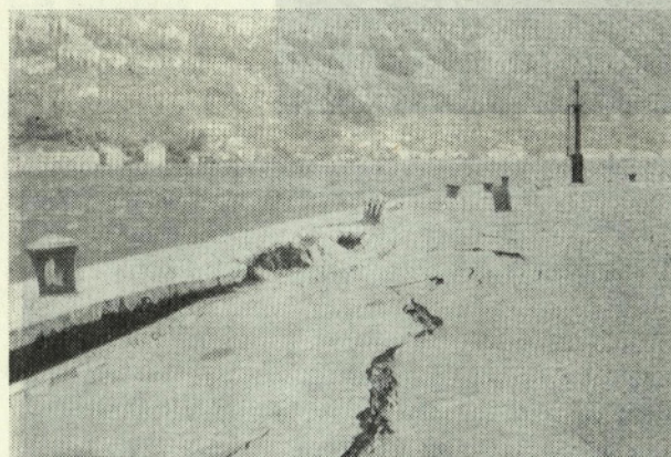
Slika 3. Poškodbe pristanišnega pomola v Kotoru
