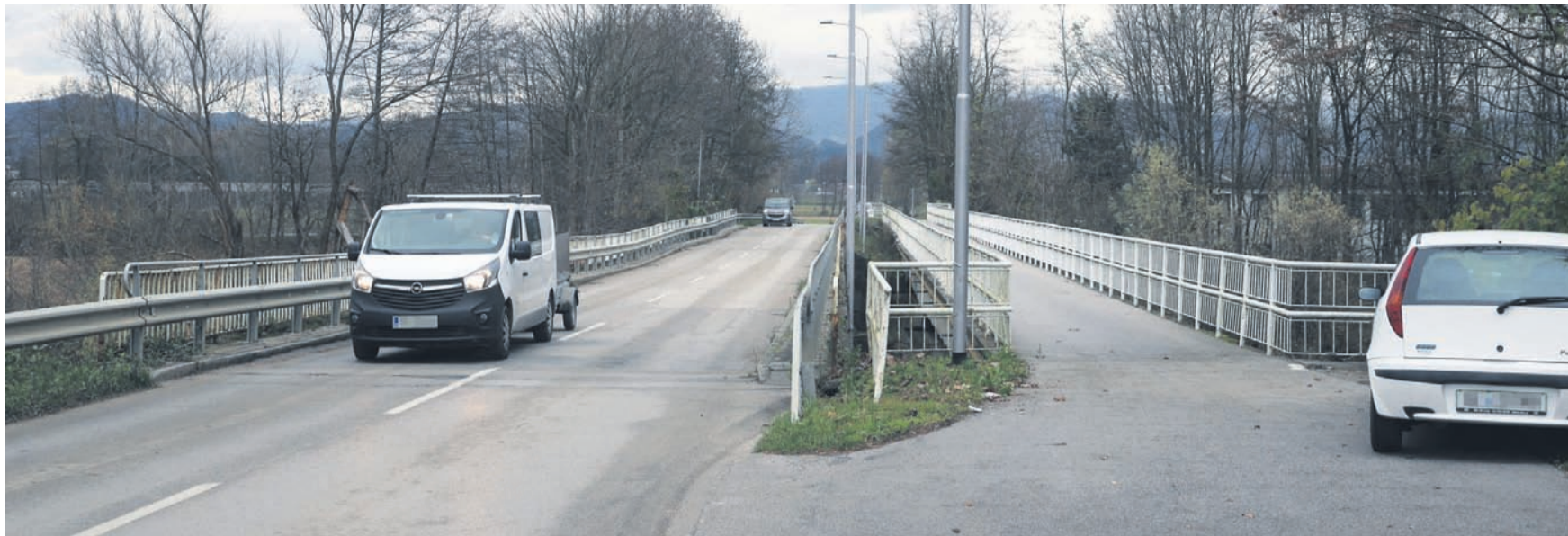
Da se bo most počasi sesedel, krajanje opozarjajo že dolgo. Težave se zaveda tudi občinska oblast. A se vedno zatakne pri denarju. Kmalu bo promet čez most izmenično enosmeren, s čimer bodo zmanjšali možnost, da bi prišlo do preobremenitve. Občani se kljub vsemu sprašujejo, ali je most še dovolj trden. Župan zagotavlja, da je.
