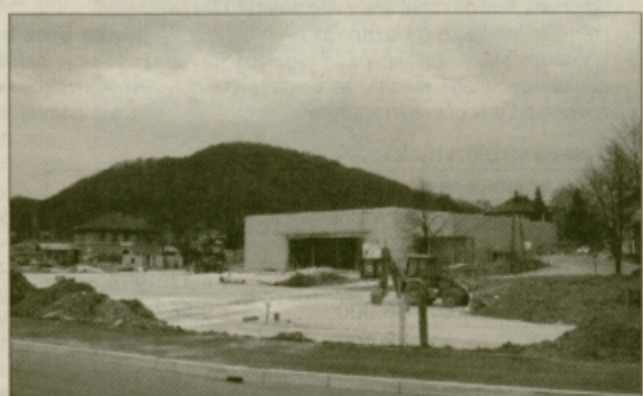
V Rogatcu, ki postaja eno samo gradbišče, bodo sredi maja odprli veliki trgovski center.
