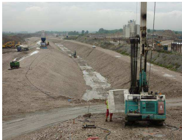
Slika 4 (stanje maj 2016): Gradnja nasipov bazena je bila v maju 2016 še v polnem zagonu. Na sliki je spodnji del nasipa pri jezovni zgradbi HE Brežice, ki je v zgodnji fazi gradnje sestavljen iz dveh delov, med katerima se izvaja tesnitev podlage s tesnilno zaveso.
