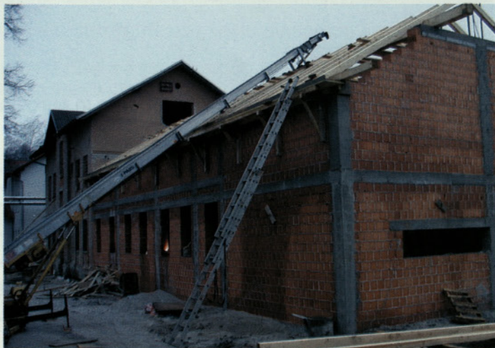
Novogradnja ERICa Velenje, v stavbi bo 600 m 2 površin, katerih dobri dve tretjini bosta namenjeni laboratorijem.
