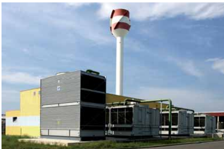
Hladilni stolpi za tehnološko vodo
