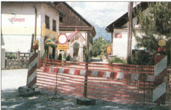
Obnova Glavne ceste bo končana do 10. julija, kljub delom in zapori prometa bo med gradnjo urejen dostop do vrtca, pošte in občine.
