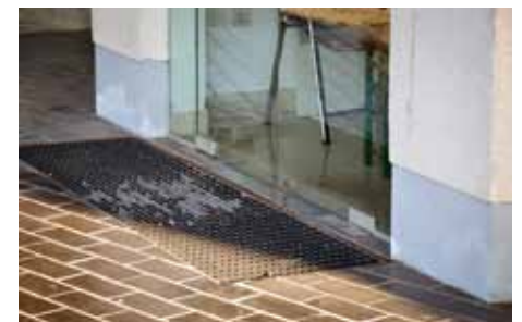
Vhodna vrata se pri odpiranju zatikajo, inventar v slabem stanju.
