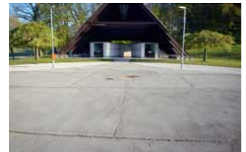
Razpokana površina pred vežico
