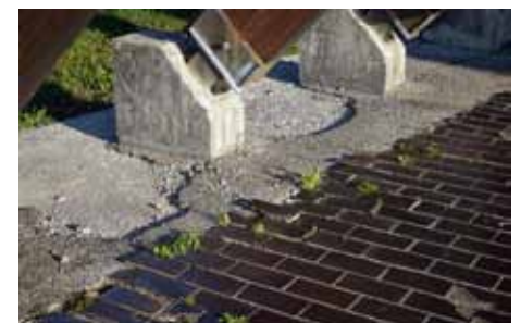
Betonska plošča in podporni nosilci potrebni obnove
