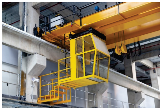
Slika 30: Prostor med hodnikom vzdolž žerjavne proge in kabino upravljavca žerjava
