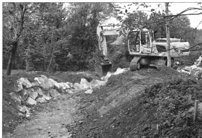
Podjetje Nivo čisti in utrjuje brežine Mostnega grabna v Potoku in ureja izliv potoka v Dreto (foto: Tatiana Golob)
