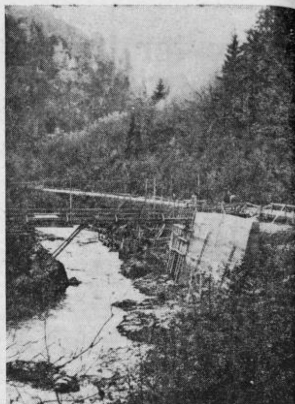
Od Savinje izpodjeden nasip med Lučami in Strmcem je močno ogrozil cesto. Čeprav se je na nekaterih mestih obrežje zrušilo že v pomladnih dneh, so začeli končno kritična mesta popravljati. Posnetek prikazuje gradnjo nasipa, ki ga gradi celjsko gradbeno podjetje Ingrad.
