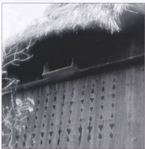
Slika 7: Runeč 24: Čelni zatrep podstrešja – »svišli« z ornamentalno izrezljanimi prezračevalnimi linami v obliki srčkov in lističev
