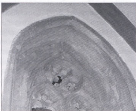
Slika 6: Kapela - severno okno. Foto: B. Vnuk
