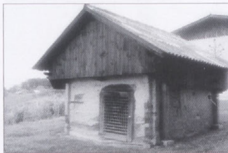
Slika 22: Mala vas pri Ormožu: Neustrezno obnovljena klečaja, potem ko so spremenili strešno konstrukcijo in slamnato kritino zamenjali s salonitom
