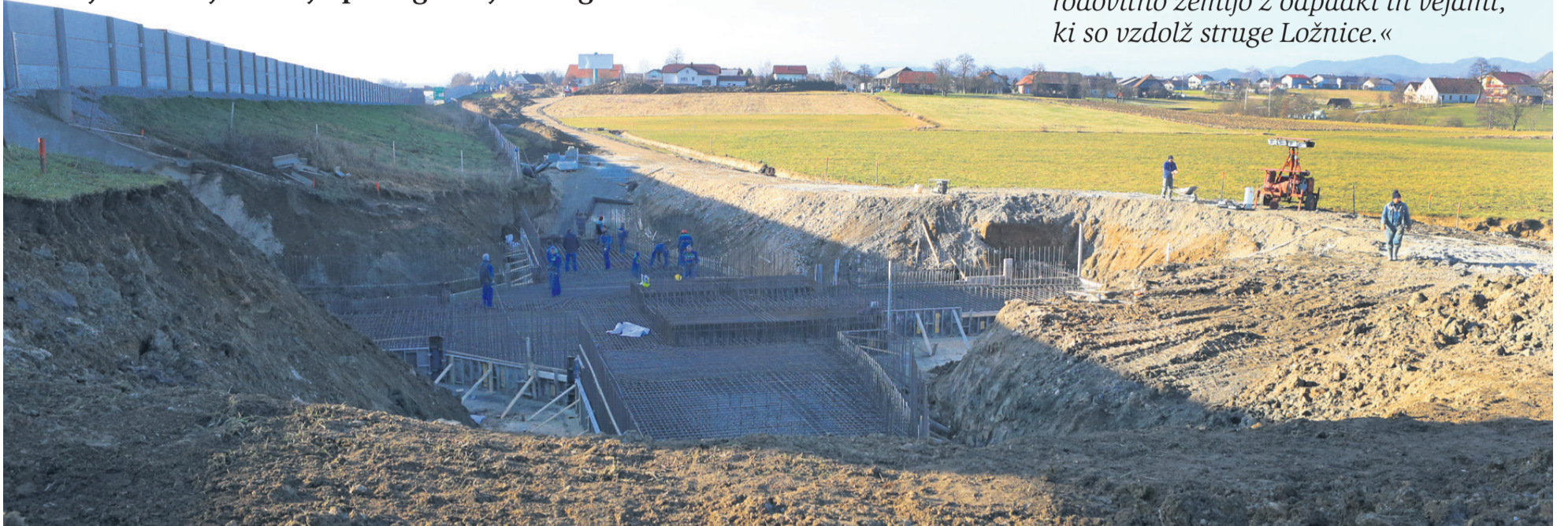
Na pospešeno gradnjo suhega zadrževalnika na območju vzhodne Ložnice pri Ljubecni, tik bo avtocesti, so se tamkajšnji kmetje odzvali z ostrim protestom.
